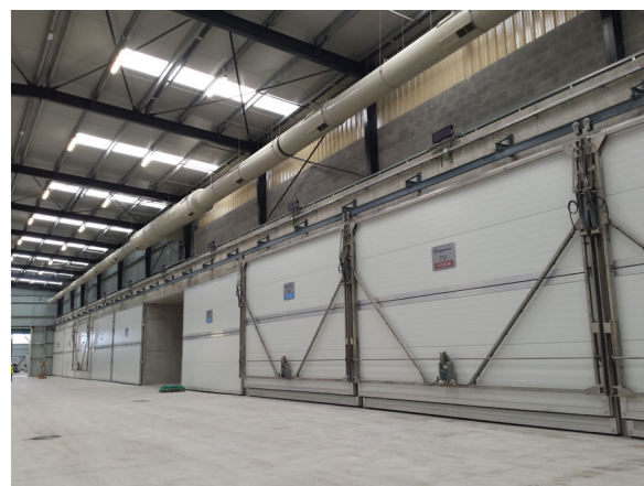
Túneles de compostaje.
