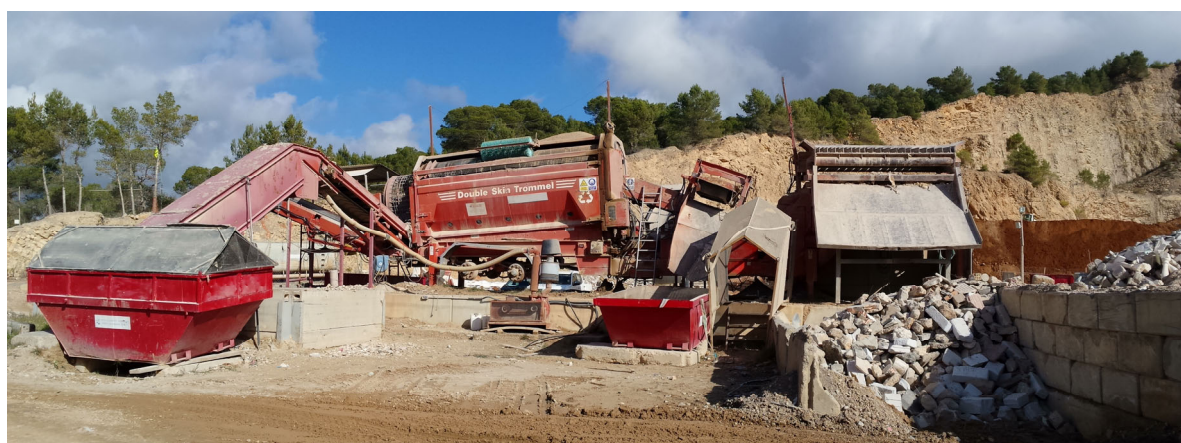
Equipos de tratamiento y selección de RCD en las instalaciones de Santa Bárbara.
