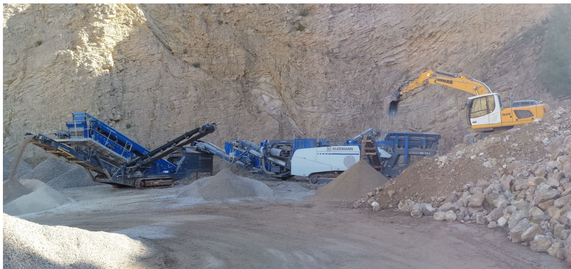
Equipos de trituración y cribado de tierras en las instalaciones de Santa Bárbara.
