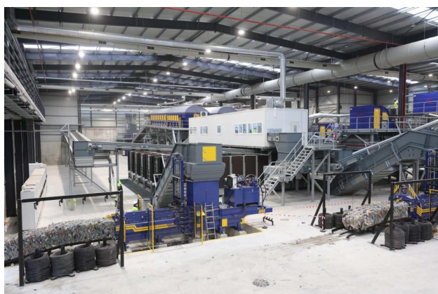
Equipos de pretratamiento.
