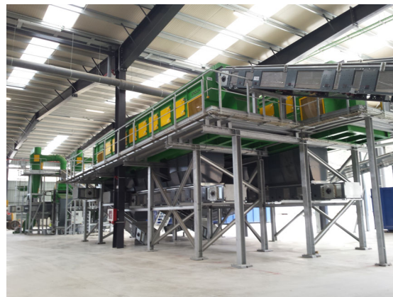
Equipos de afino.
