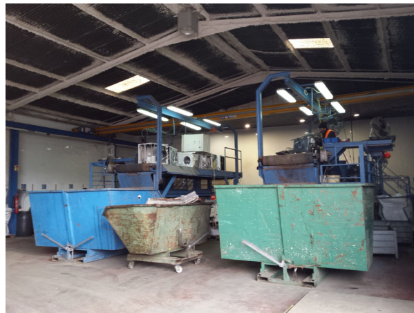
Equipos de despiece y recuperación de RAEE.
