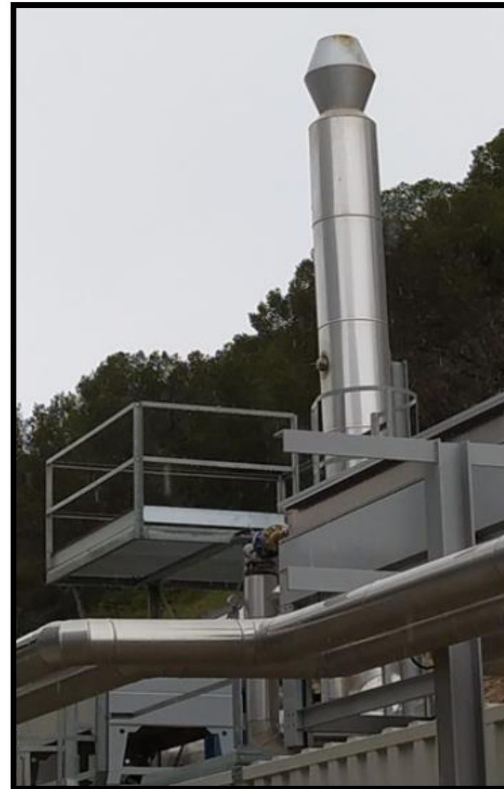
Chimenea Motor Cogeneración
