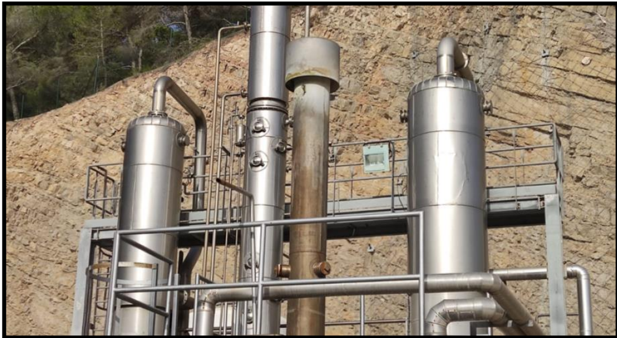
Chimenea Caldera Biogás
